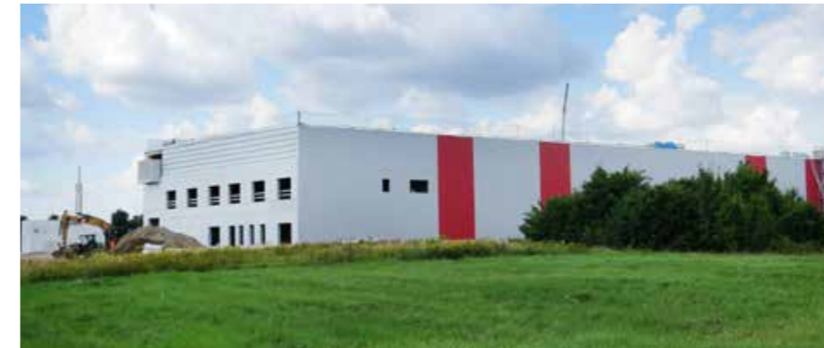
Nimmt Gestalt an: Die Bauarbeiten am künftigen Firmensitz der WEFO-tec Deutschland GmbH im Gewerbegebiet Markendorf in Frankfurt (Oder) gehen planmäßig voran. Bis zum Jahresende soll der Bau der ersten Halle abgeschlossen sein. Sobald diese steht, wird mit dem Bau der zweiten Halle begonnen. Parallel dazu wird die Produktionsaufnahme vorbereitet.
